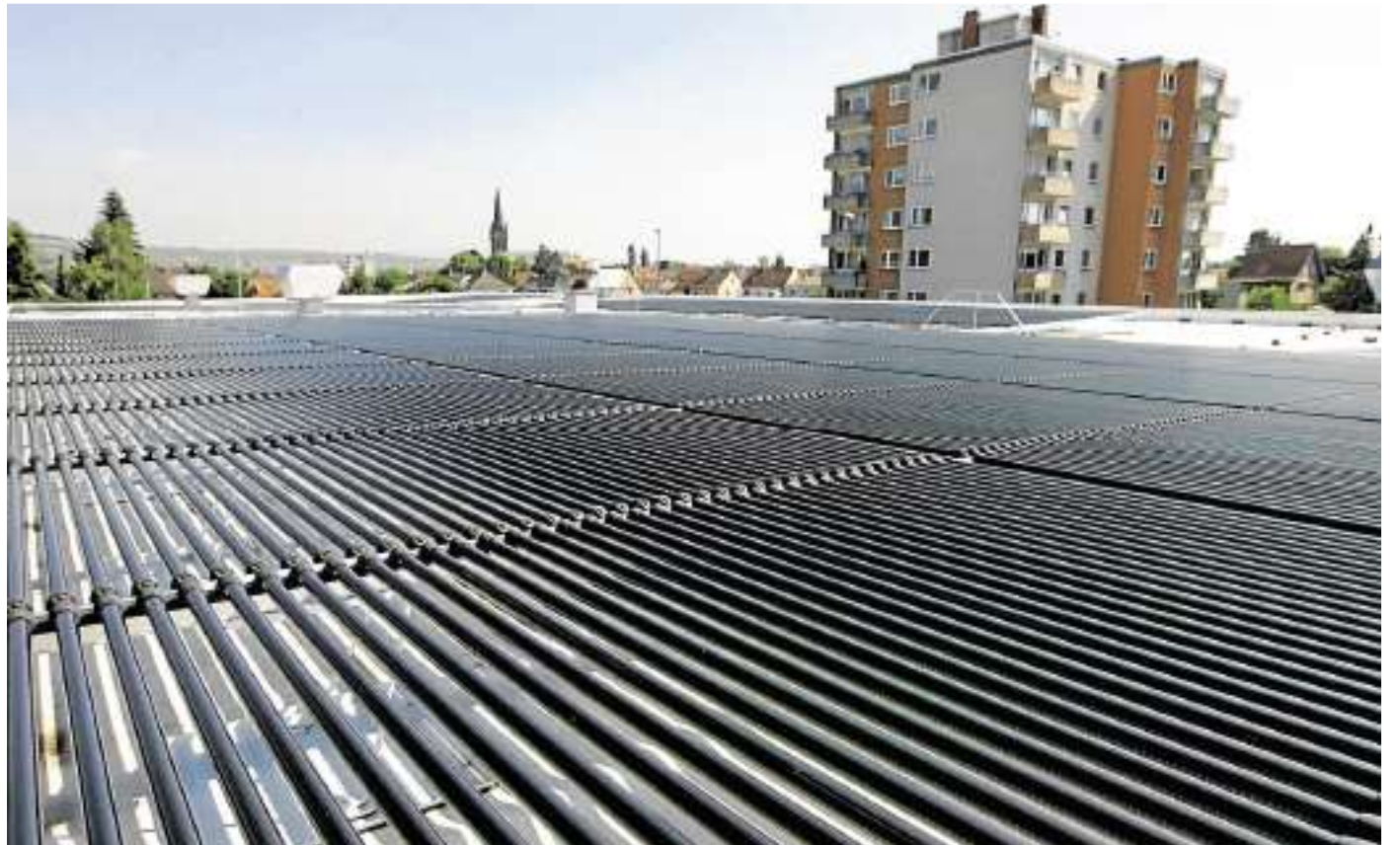
Im Mai 2011 wurde die Photovoltaikanlage auf dem Hallendach der Verkehrsbetriebe in Dietersheim eingeweiht.
